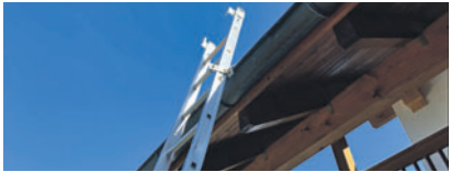
Der Verunfallte wollte Arbeiten an einem Dach vornehmen. (Foto: LPFL)
