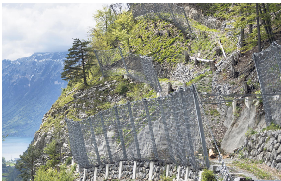
Solche Netzverbauungen dienen dem Schutz vor Steinschlägen.
